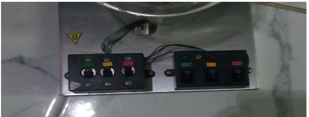
Figura 22: Imagem real caixas patola fixa na base de alumínio.
