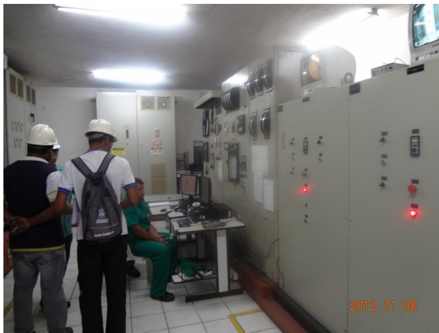
Fig. 24: sala de controle das caldeiras
