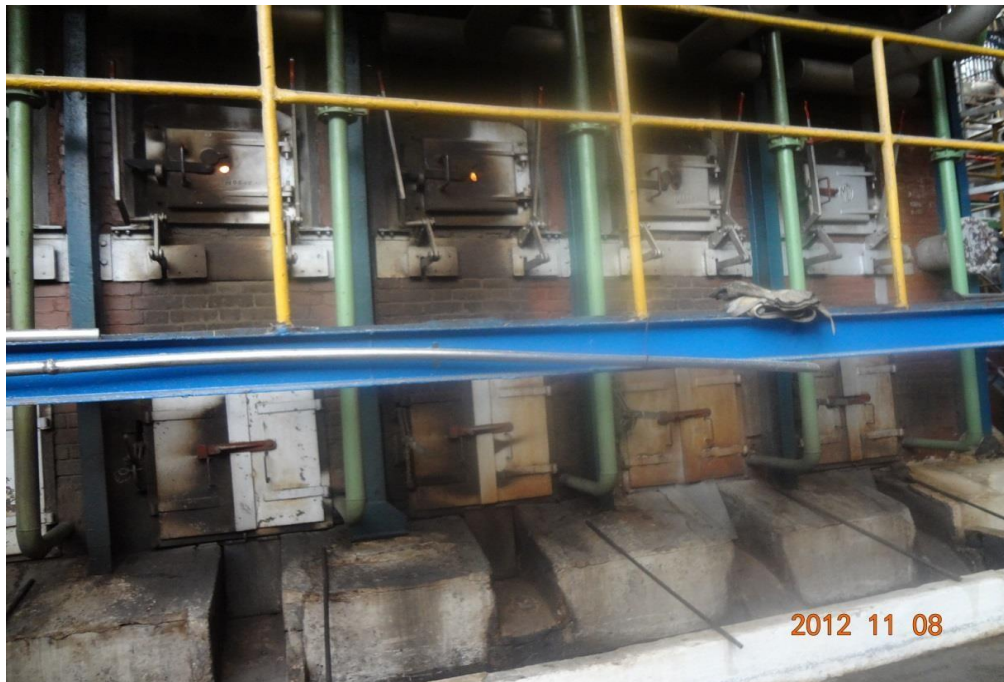
Fig. 23: vista frontal das caldeiras
